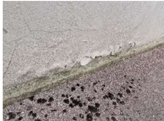
Foto Nr. 4.1.4. Bojāta cokola apdare
