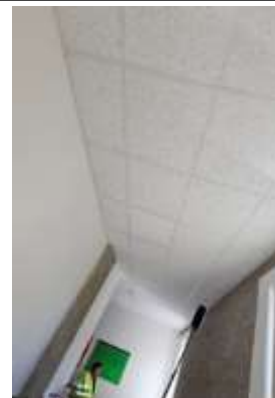
Foto Nr. 5.3.2.2. Telpas daļa nav aprīkota ar UATS sistēmas detektoriem.
