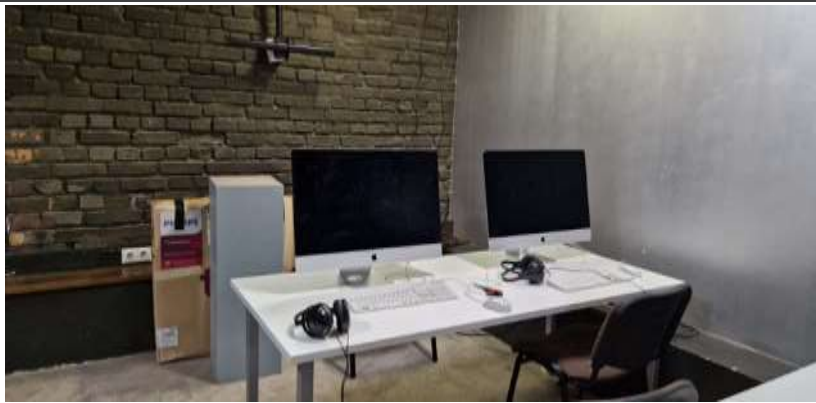
Foto Nr. 4.1.7. Bojāta cokola apdare
