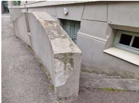
Foto Nr. 4.1.3. Bojāta cokola apdare
