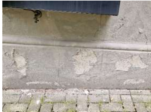
Foto Nr. 4.1.2. Bojāta cokola apdare
