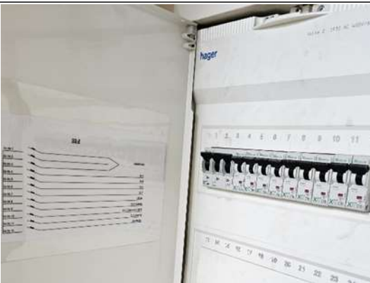
Foto Nr. 5.2.4.3. Informatīva bilde – elektriskā sadalne labā tehniskajā stāvoklī, sadalnes iekšā ir ievietota elektriskā shēma.
