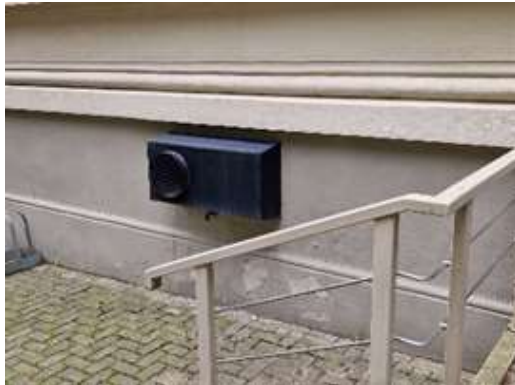
Foto Nr. 4.1.1. Bojāta cokola apdare
