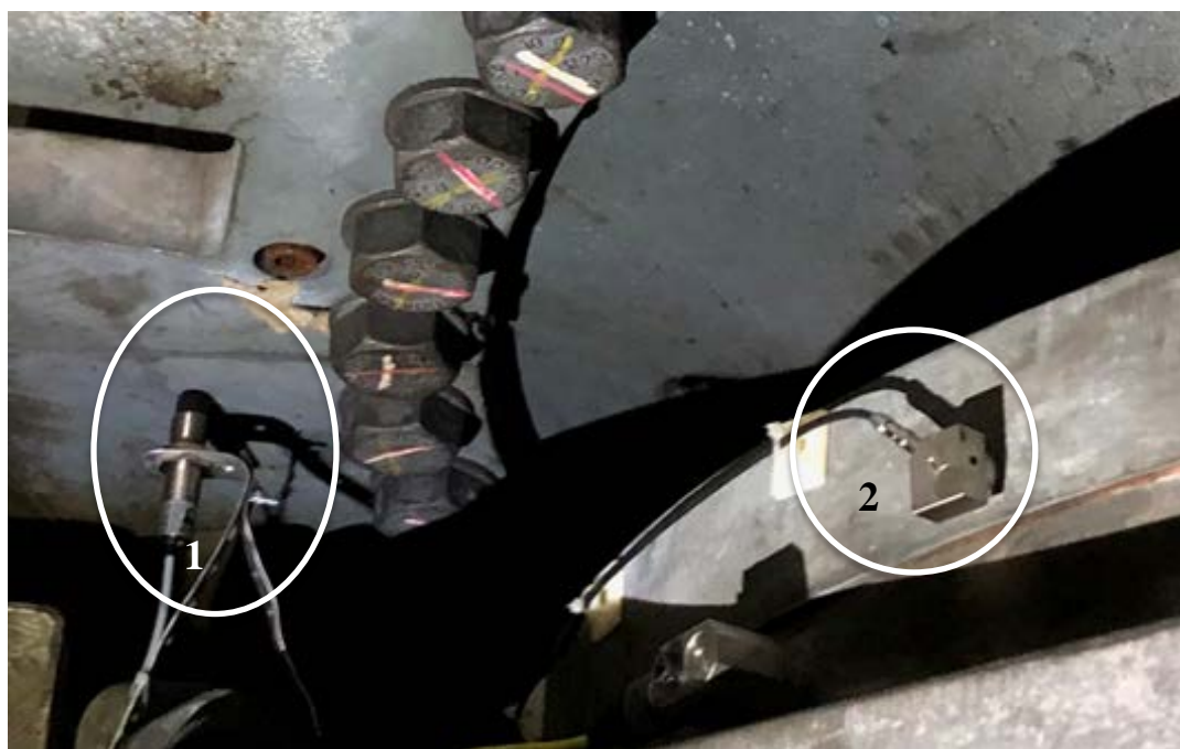
Att.1. Rotācijas sensora (1) un vibrācijas sensora (2) uzstādīšana uz galvenā korpusa
